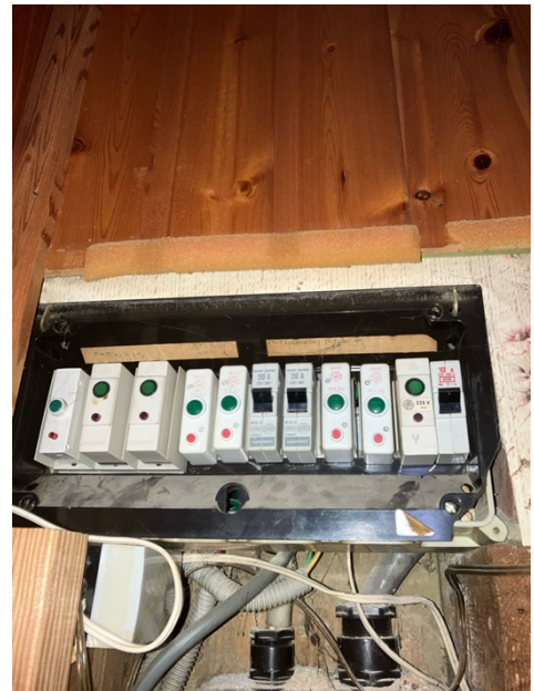
( Elektrisch bord - binnenkant )
