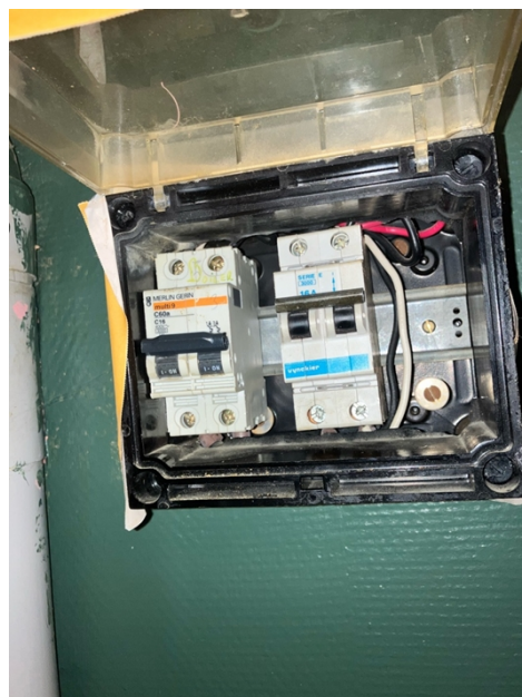
( Elektrisch bord - binnenkant )
