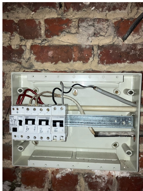
( Elektrisch bord - binnenkant )
