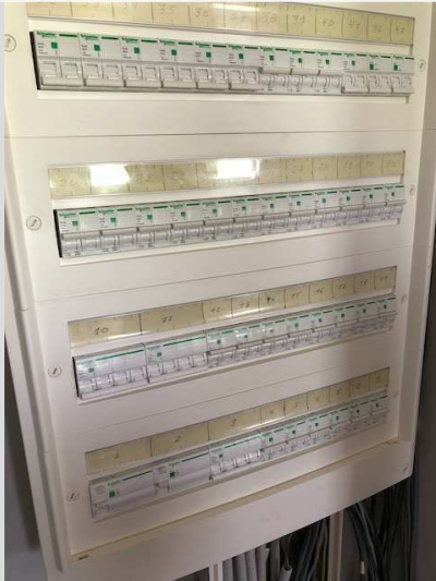
( Tableau électrique photo extérieur )
